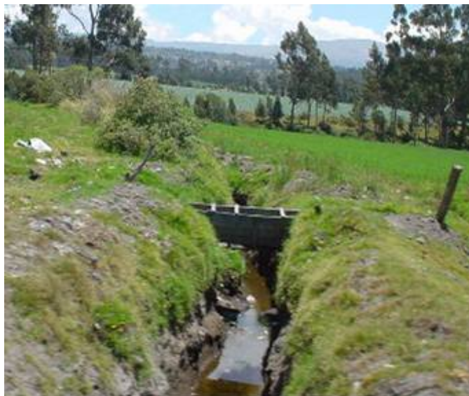
Figura 8. Infraestructuras de conducción hídrica.
